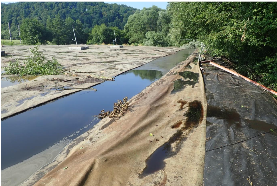
Fotografia č. 2 Trhlina vzniknutá na západnej časti Bag tanku v dôsledku pádu stromu
