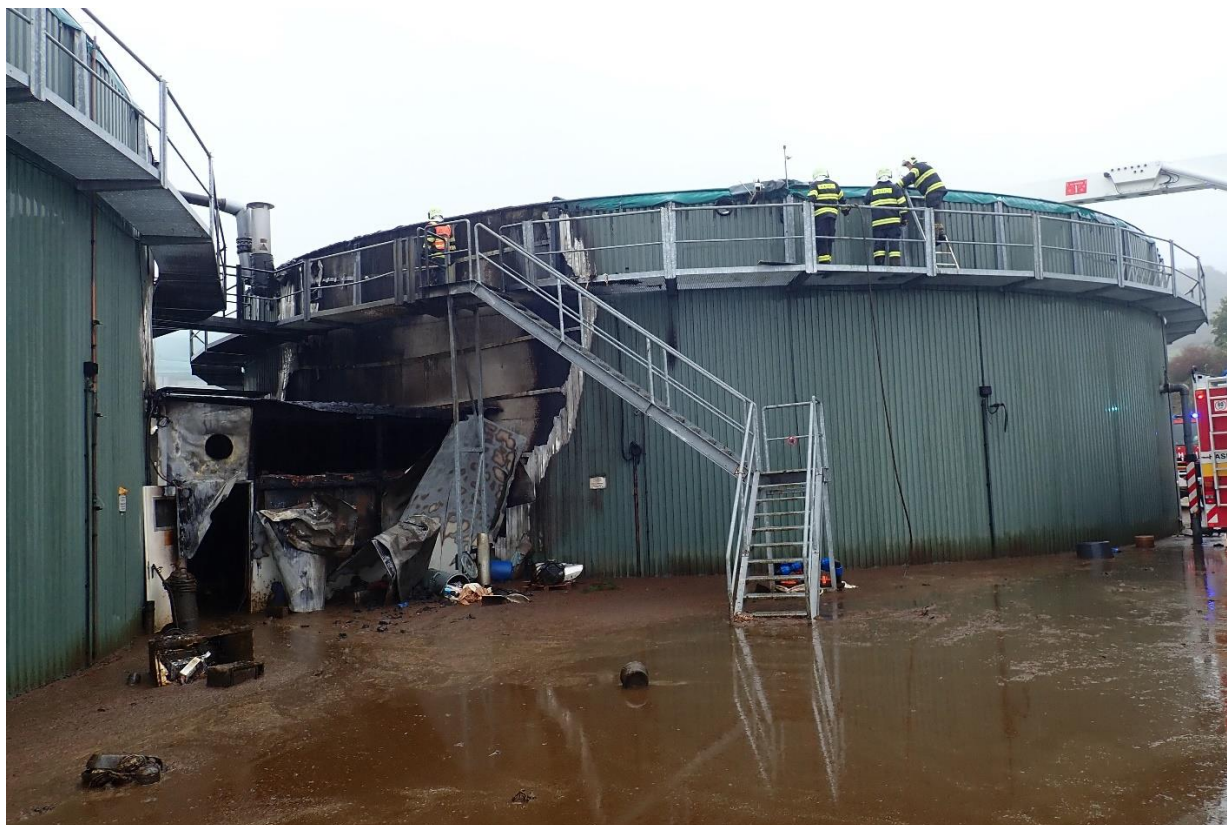
Obr. č. 8 Pohľad na požiarom zničené nádrže na fermentát
