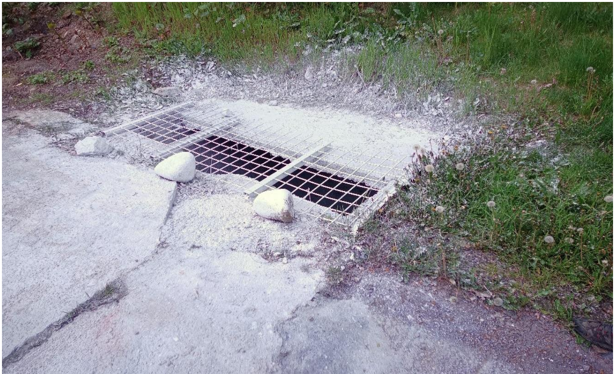
Obr. č. 2 Znečistená kanalizačná vpust' bielou nerozpustnou látkou
